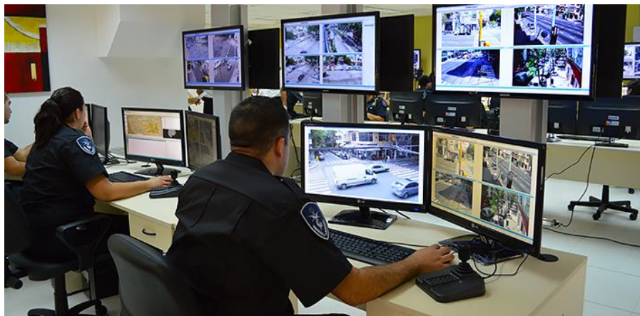
Figura 32: Sala de Monitoreo – Seguridad Ciudadana
