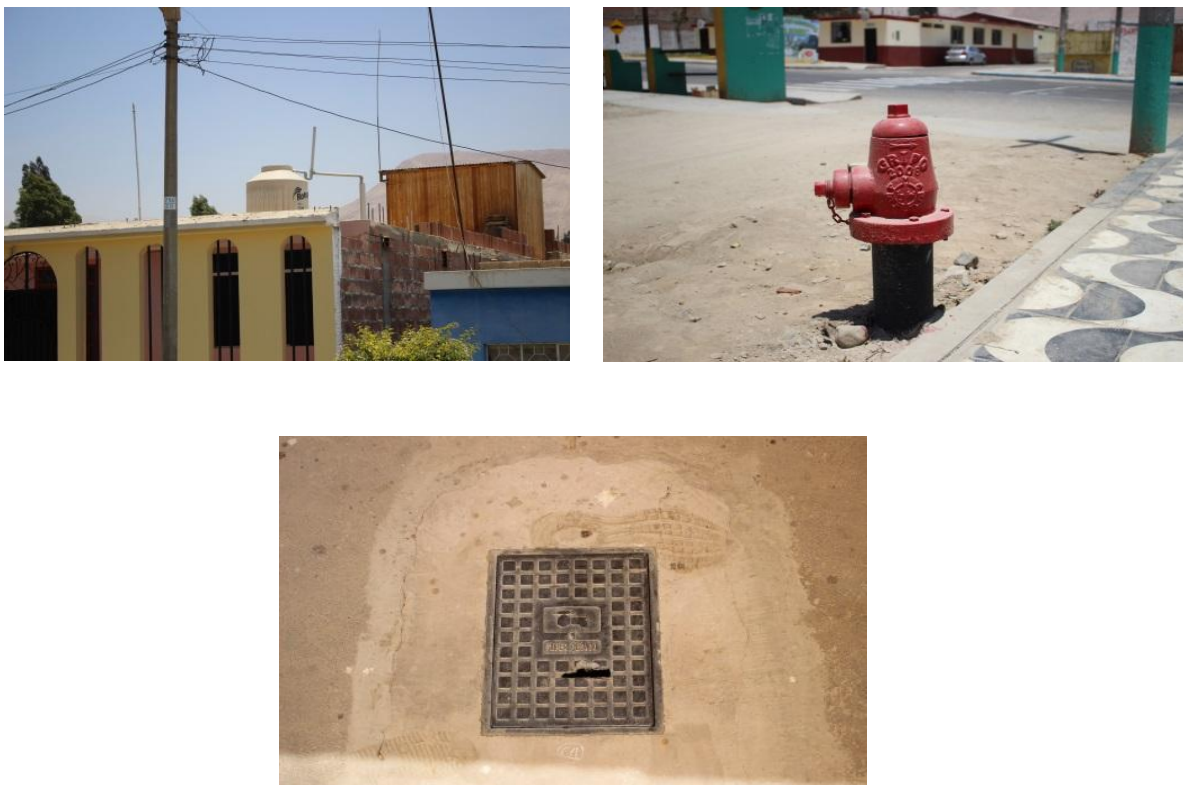
Imagen 27: Tanto cajas de registro agua, tanque elevado y llave de agua para la ayuda a los bomberos
